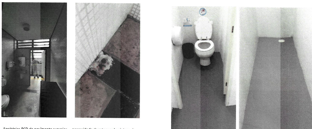
Sanitários PCD do pavimento superior - necessidade de retoque da pintura de proteção da viga do piso
