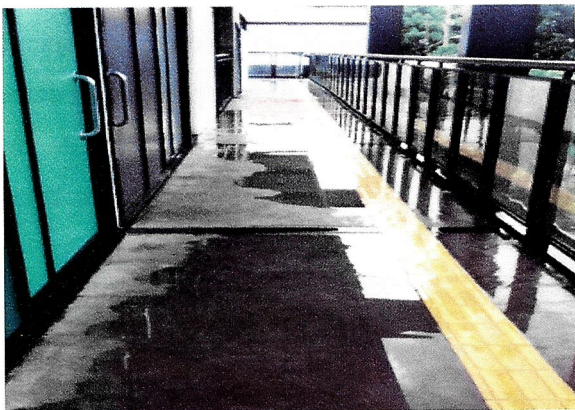
Antes – salas e corredor alagada
